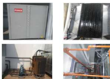
ระบบ Heat Pump
