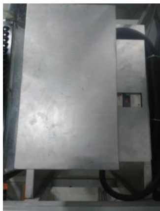
ระบบ Heater
