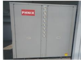
ระบบ Heat Pump
