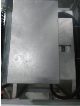
ระบบ Heater
